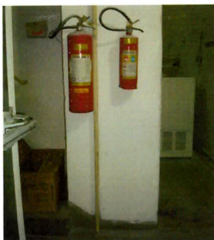
Figura 20 – Classificação do extintor obstruída
