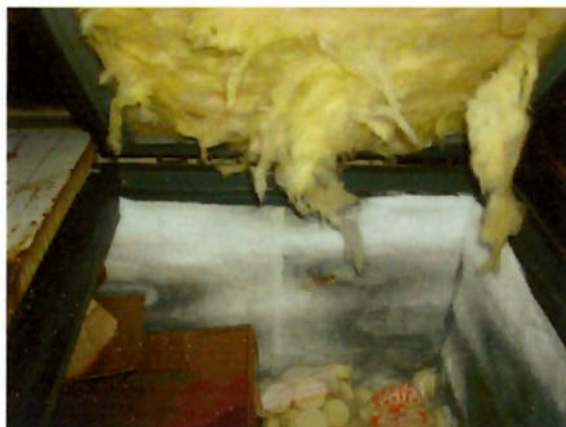
Figura 35 – Vedação da tampa do freezer comprometida
