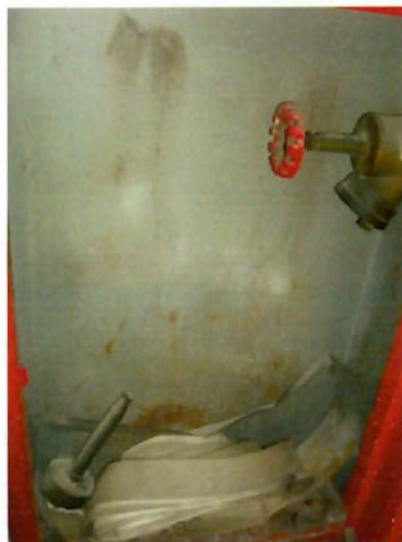
Figura 21 – Hidrante sem suporte para a mangueira
