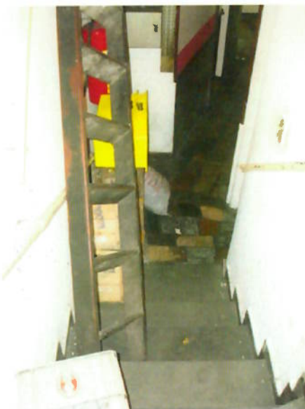
Figura 18 – Escada com caixa de bebida, escada de madeira, favorecendo acidentes
