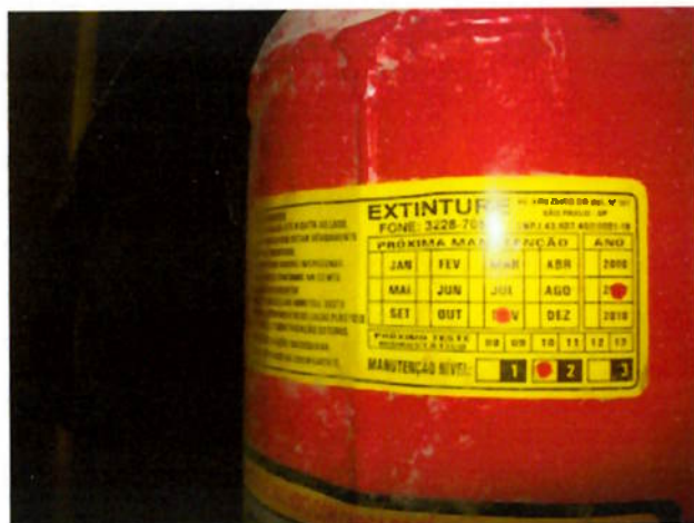
Figura 19 – Extintor com validade vencida
